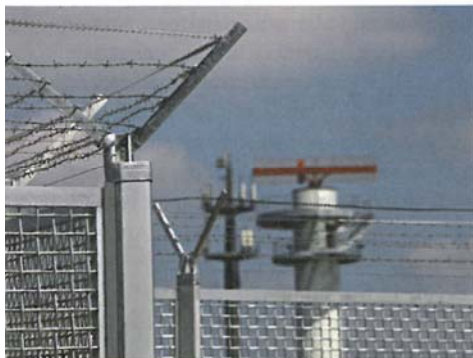
Aluminiumzaunsystem mit elektrisch überwachten Übersteigsicherungen.
