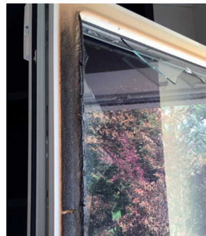
Die innere Glasschicht von Fenstern und Türen hielt aufgrund der PROFILON®-Beschichtung stand.
