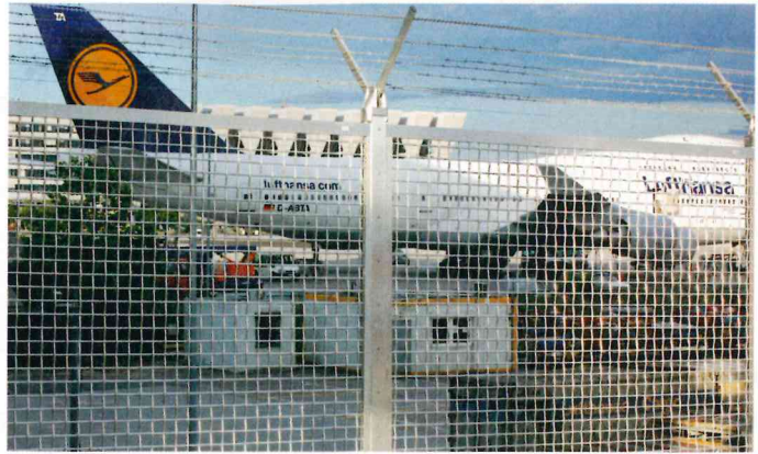
Der von Haverkamp entwickelte Alarmzaun Alugard mit Aluminium-Wave-Füllung sichert die neue Landebahn des Frankfurter Flughafens
